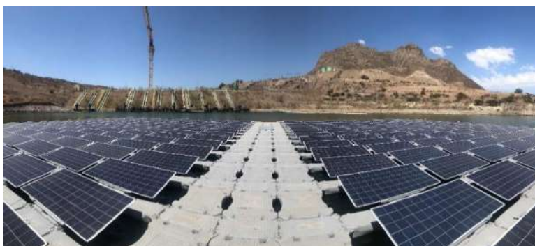
Figura 10. Planta solar fotovoltaica flotante, Las Tórtolas
