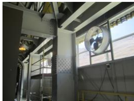
Figura 5: Nave de Molienda, nivel Chillers, Ventiladores de apoyo.
